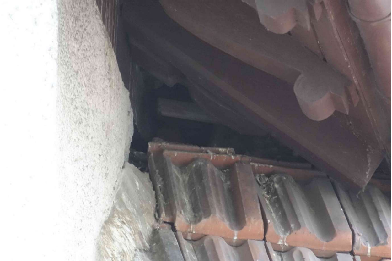
Abb. 5: Traufe des Zwerchhauses von Haus Landstraße 27, Öffnung zum Dachboden mit Vogelkot, Ansicht von Osten
